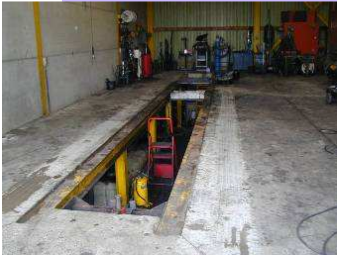
Fosse de visite non sécurisée
